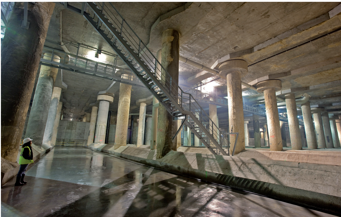
Vista parcial del interior del Estanque de Tormentas, ubicado bajo un campo de golf del Club de Campo Villa de Madrid. Cuenta con 35.000 m 2 de superficie y un volumen total de construcción subterránea de casi 720.000 m 3 . Se aprecia la zona de almacenamiento de agua y la escalera de bajada al nivel inferior.
