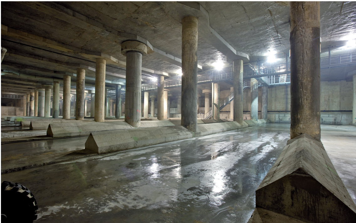
Sistema de limpieza automática de la solera del Estanque de Tormentas. Detalle de una de las calles de limpieza y de las clapetas de evacuación del agua, al fondo.
