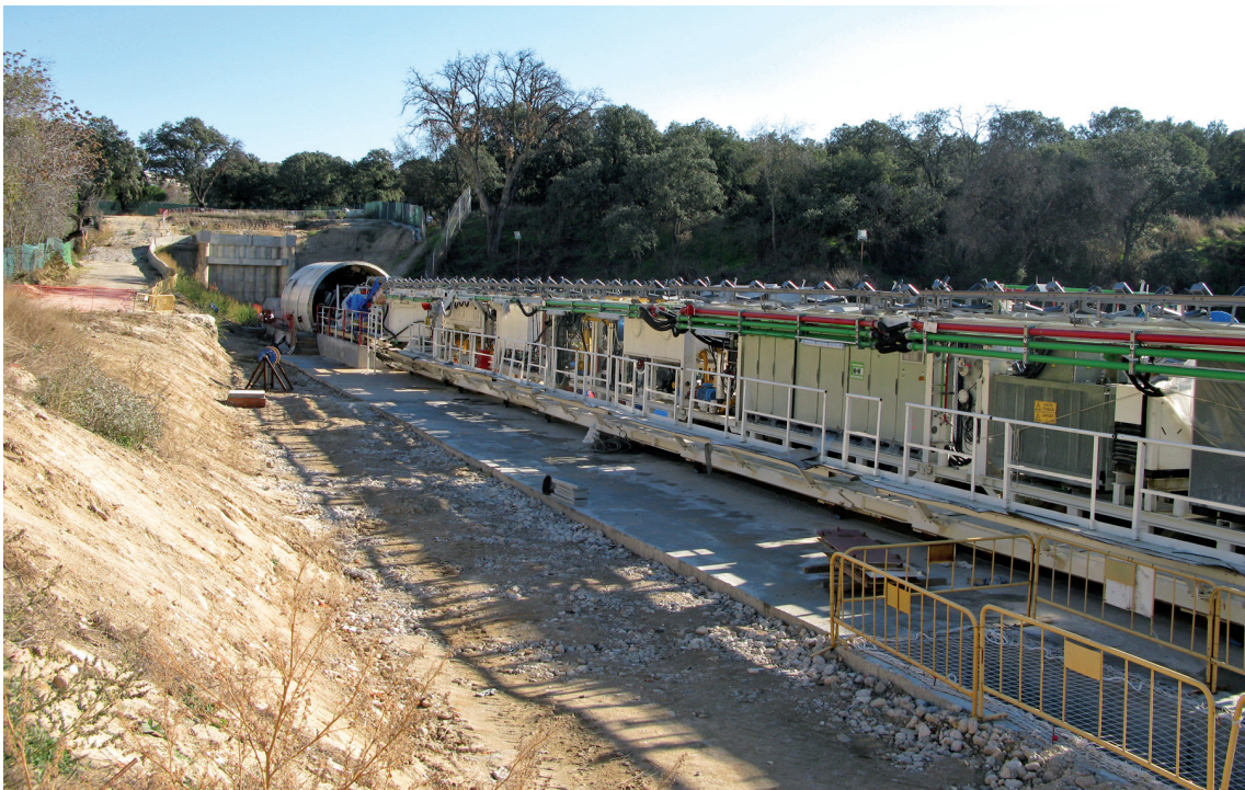
Vista general del back up de la tuneladora tipo EPB, prácticamente montada, para iniciar el frente de ataque de la excavación del túnel del Colector de Pinos.
