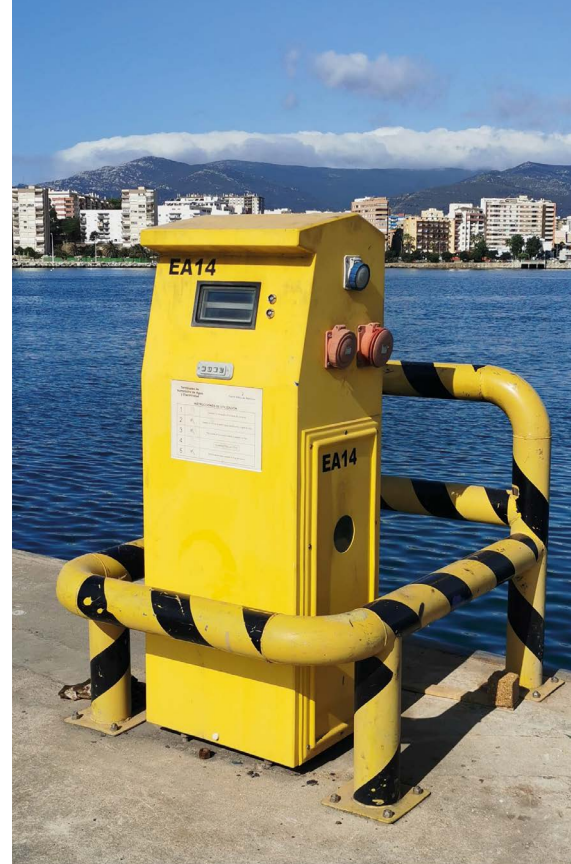
Bloque suministro agua y electricidad. Fuente: Autoridad Portuaria de la Bahía de Algeciras.
