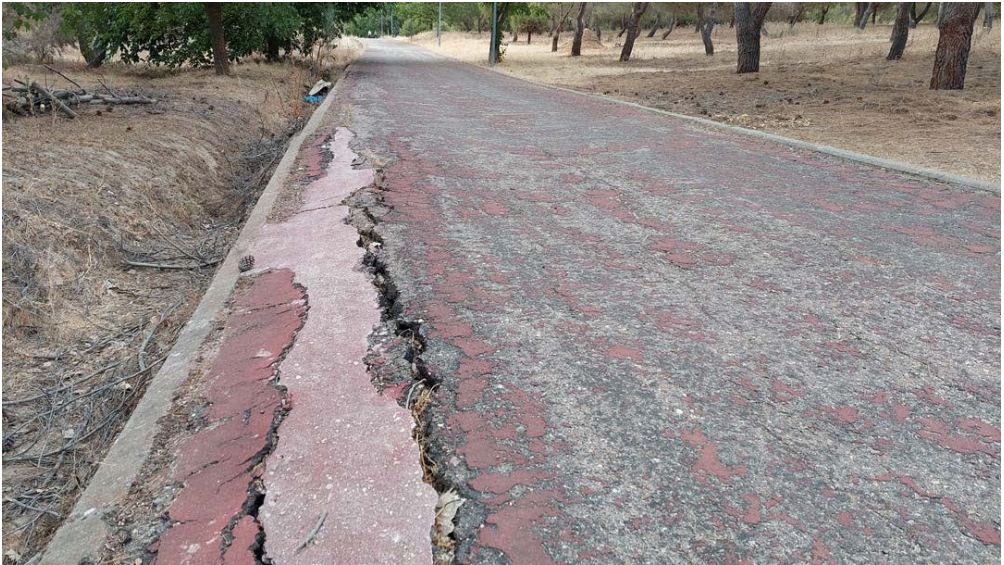
Fotografía 8.2 Ejemplo de pavimento en mal estado
