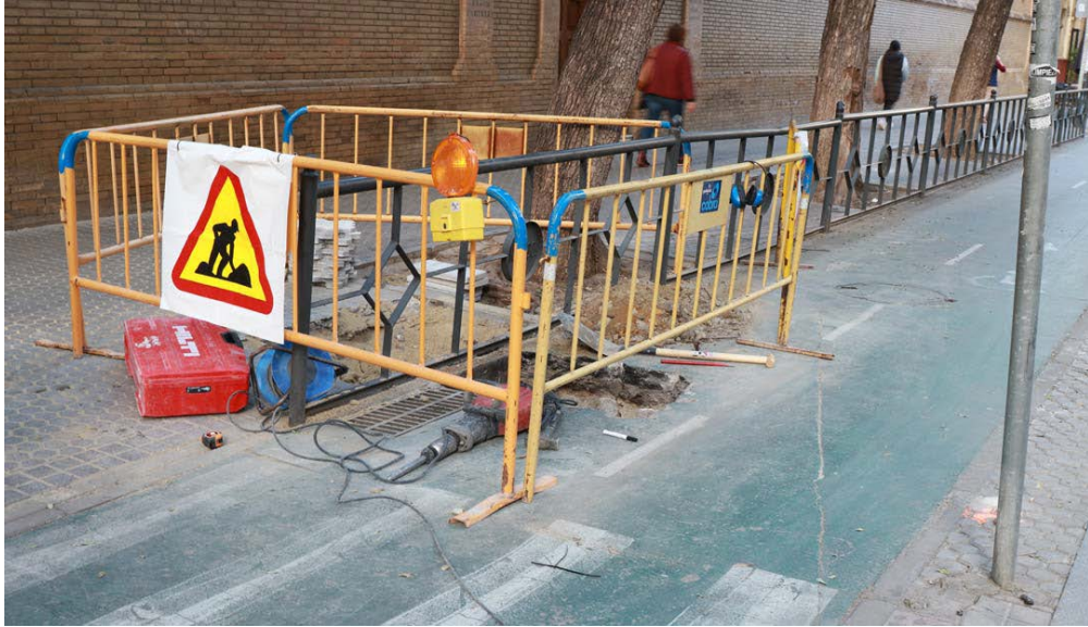
Fotografía 8.3 Las obras de reparación de servicios urbanos no siempre reponen el pavimento ciclista adecuadamente
