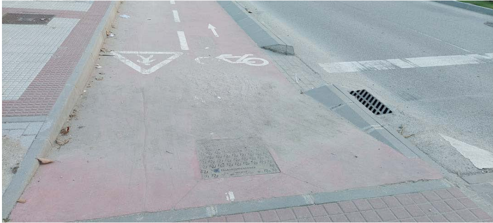
Fotografía 8.5 Ejemplo de vía ciclista con suciedad indeseable
