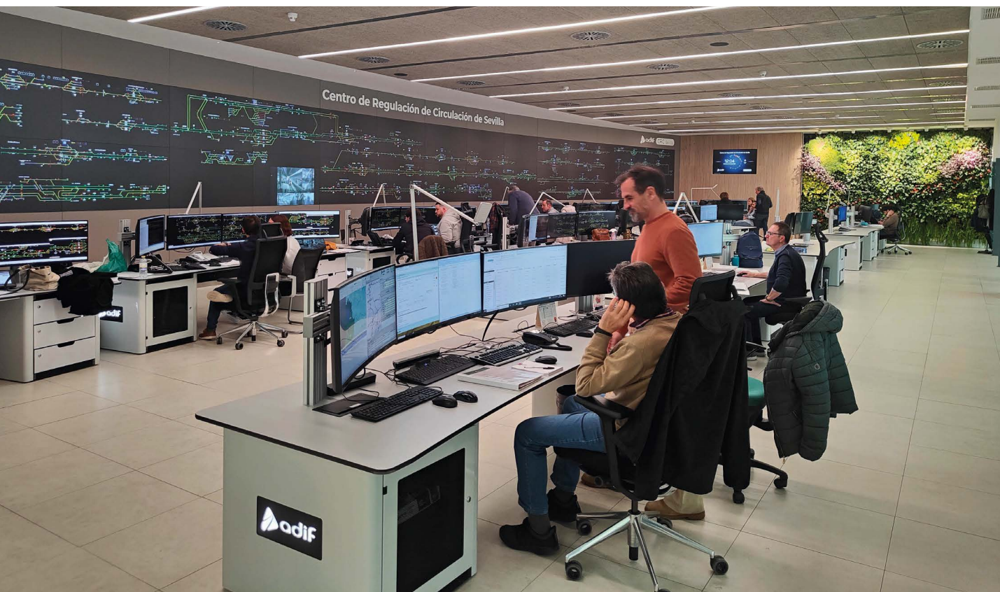
Nueva sala del CRC de Sevilla Santa Justa.
