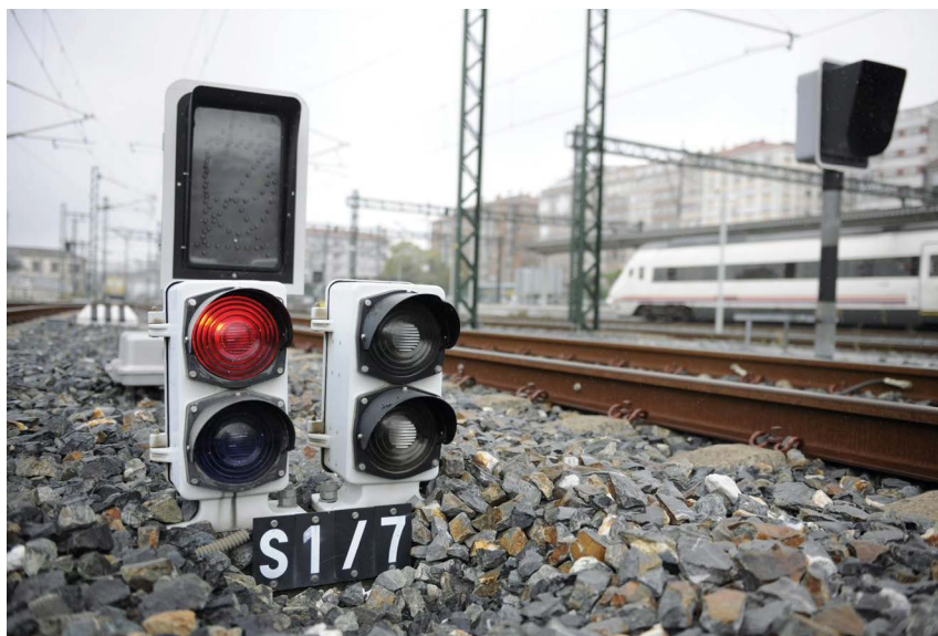
Señalización luminosa en una estación.
