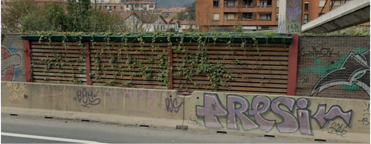
Figura 61: Vista de un tramo de pantalla de madera con un difractor-jardinera, con malla que evita la aplicación del grafiti. Se observa en las pantallas vegetales de los laterales la existencia de grafitis.
