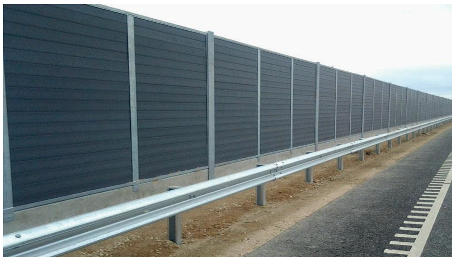
Figura 19. Pantallas acústicas fabricadas con materiales plásticos reciclados procedentes del material de rechazo de los vertederos.
