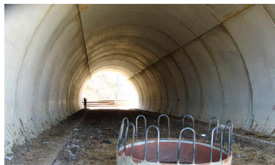
Paso de fauna cerrado como cuadra. Fuente: Fundación Oso Pardo.
