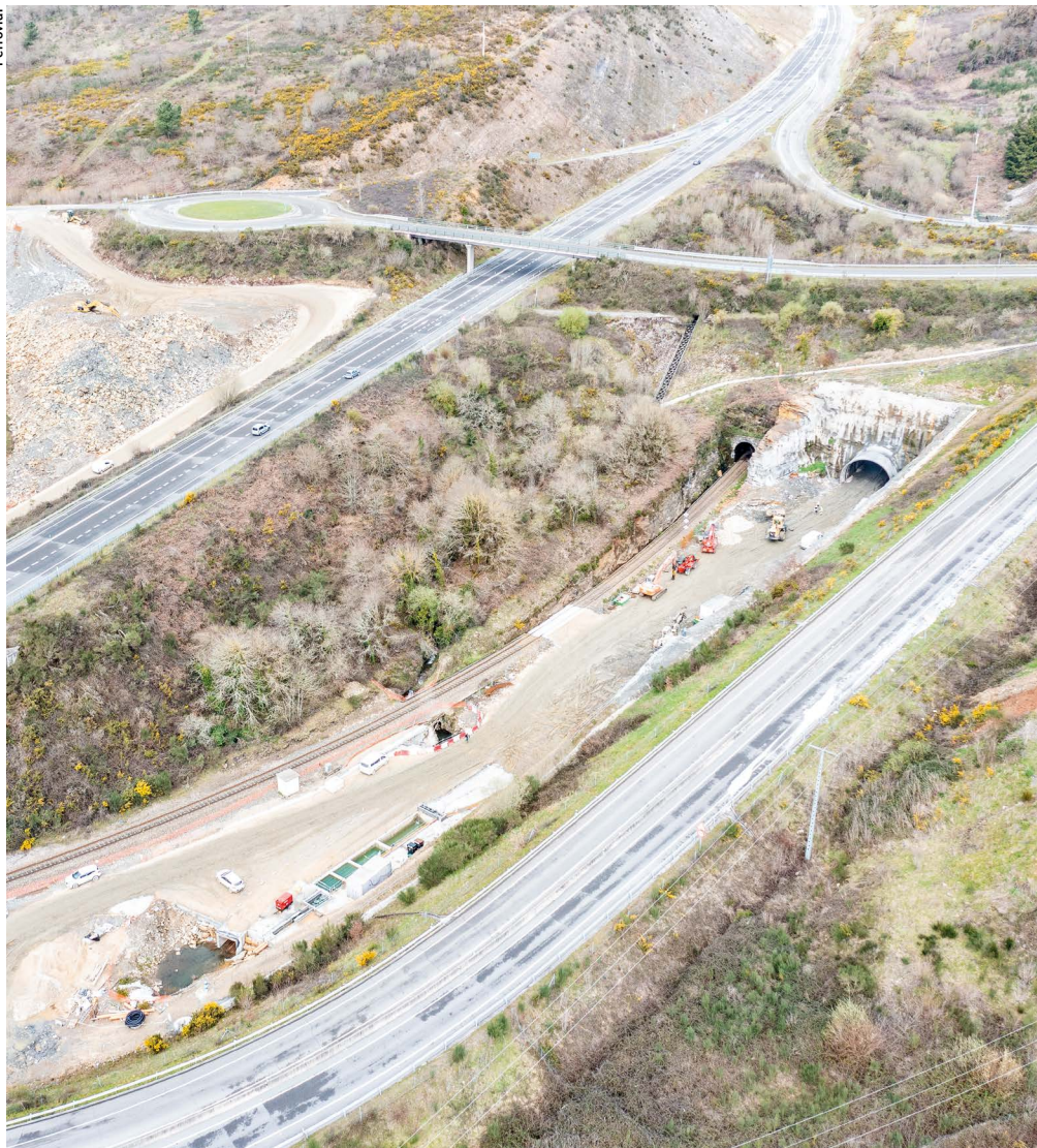
Vista aérea de las bocas sur del antiguo y el nuevo túnel de Oural.
