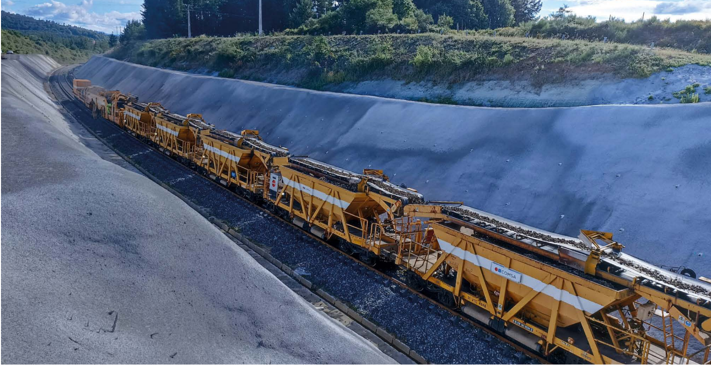
Tren cargado con balasto en una zona de trinchera reforzada del tramo Monforte-Lugo.
