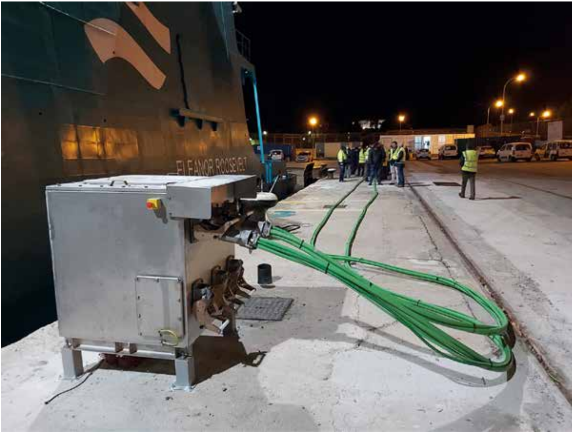
Conexión cold iron en el Puerto de Palma.
