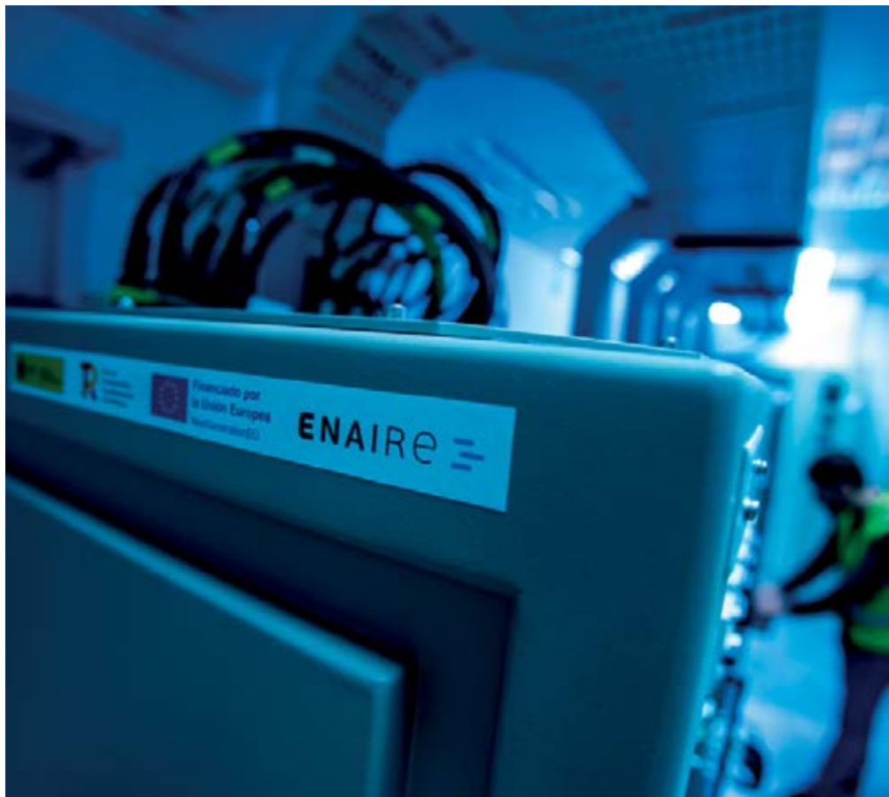
Detalle del radar 3D en Aeropuerto de Gran Canaria.
