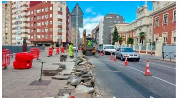
Obras en la Avenida de Álvaro López Núñez, 2023. Fuente: Periódico El Buscador. Titular: "Obras de la zona de prioridad peatonal en el acceso al Colegio Maristas en la calle Álvaro López Núñez".
