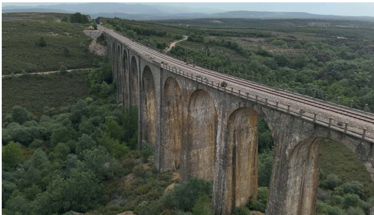
Viaducto sobre el río Truchas antes de la ejecución de las obras.
