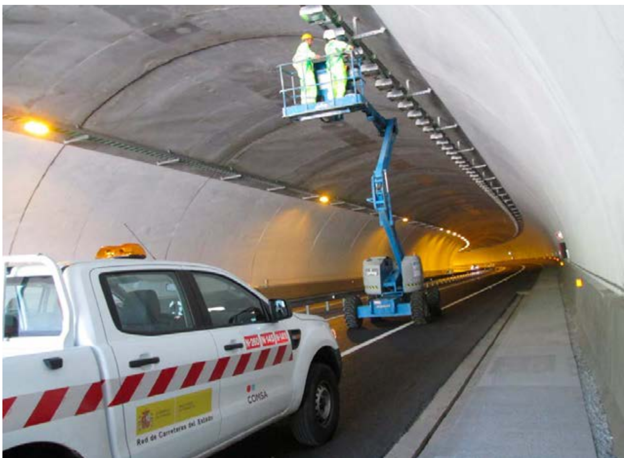
Refuerzo de iluminación en un túnel de la carretera N-260, en Huesca.
