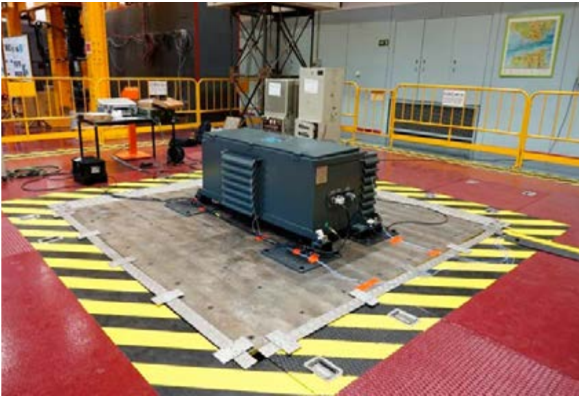
Vista general del convertidor auxiliar.
