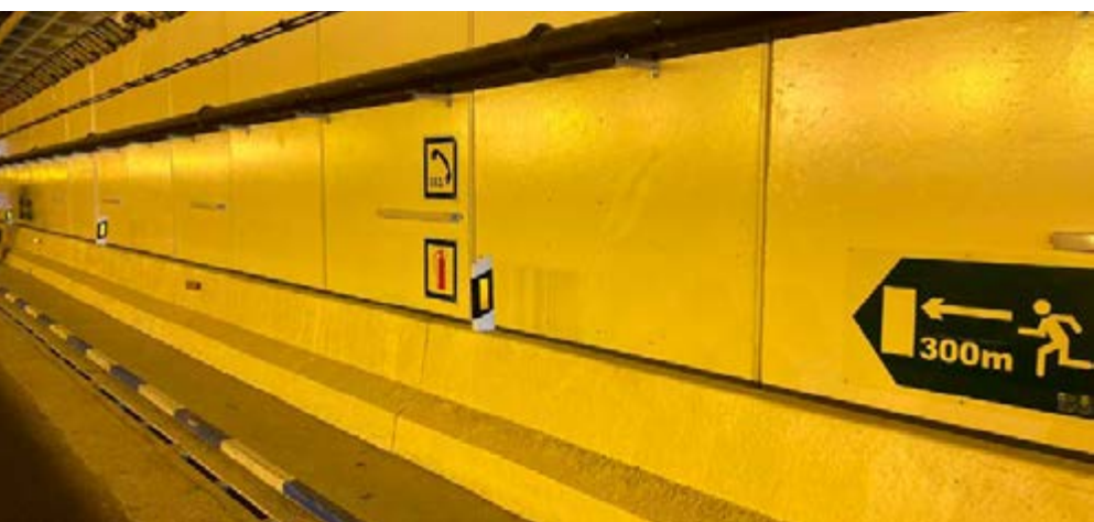
Elementos de seguridad en el túnel de Perales del Río, en la M-50 (Madrid).
