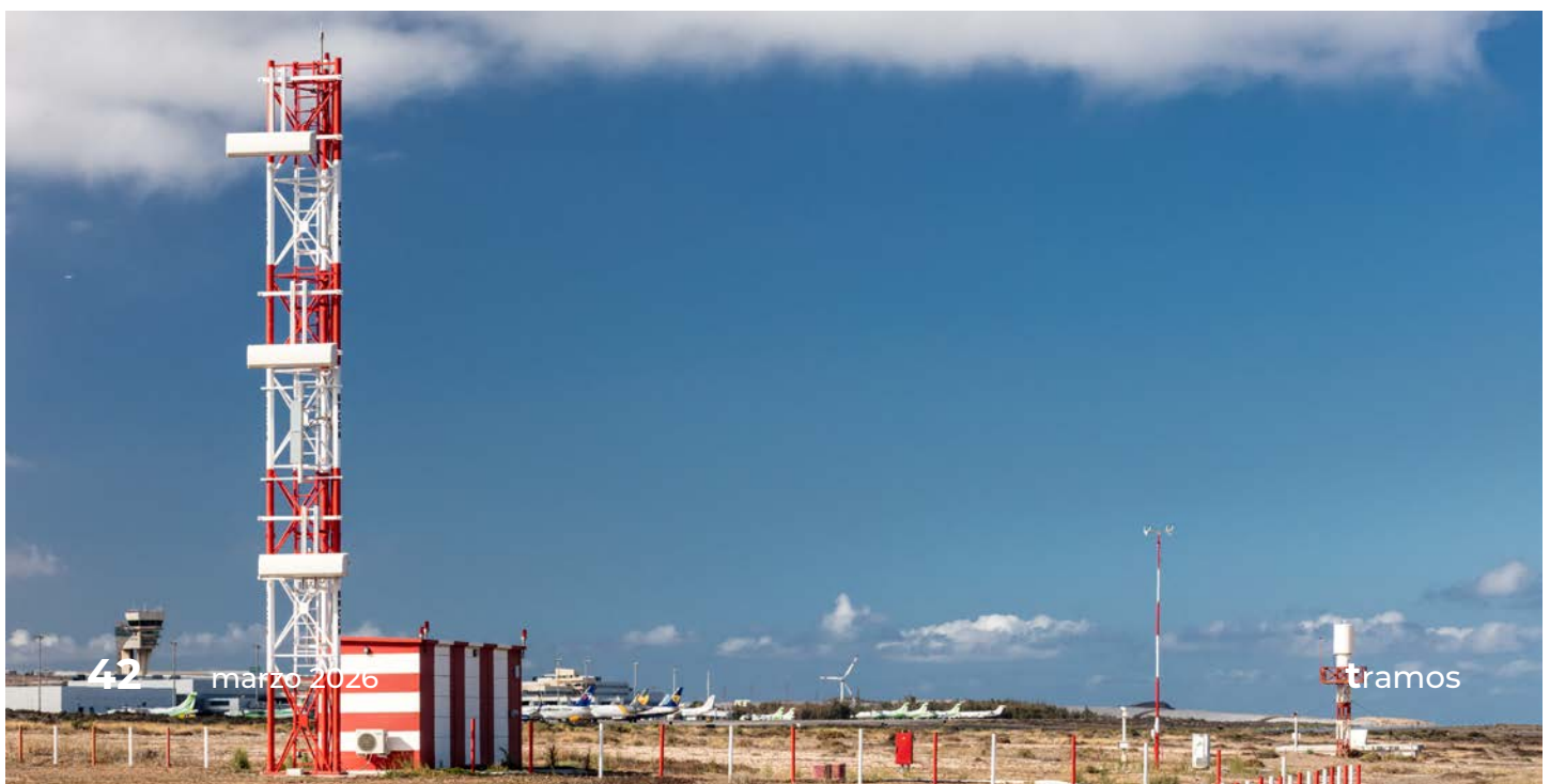
Antenas de navegación aérea en el Aeropuerto de Las Palmas de Gran Canaria.
