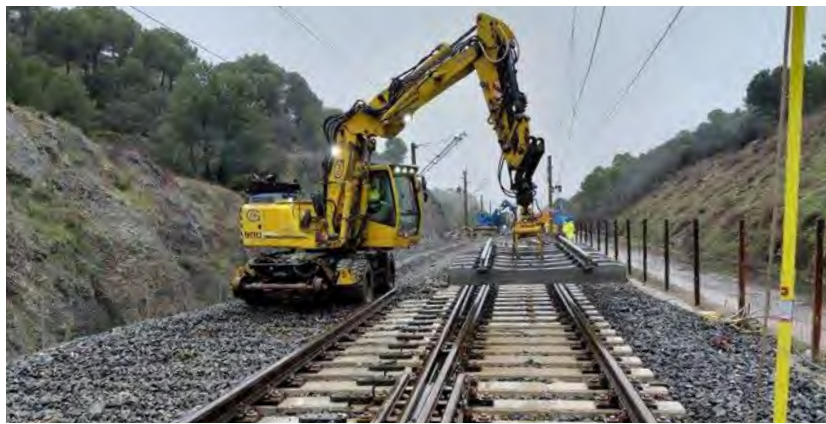
infraestructuras 10 Avanza la investigación del accidente de Adamuz
