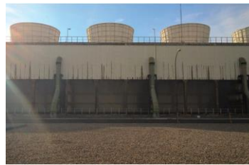
Figura 47. Torres de refrigeración de Gas Natural en Sagunto [84]
