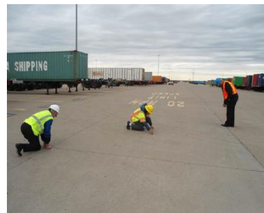
Fotografía 26. Estudio de la conservación de plataforma de almacenamiento de cargas (Unin Pacific) construido en 2005 (Dallas, TX, EEUU) tras 8 años de uso [125]
