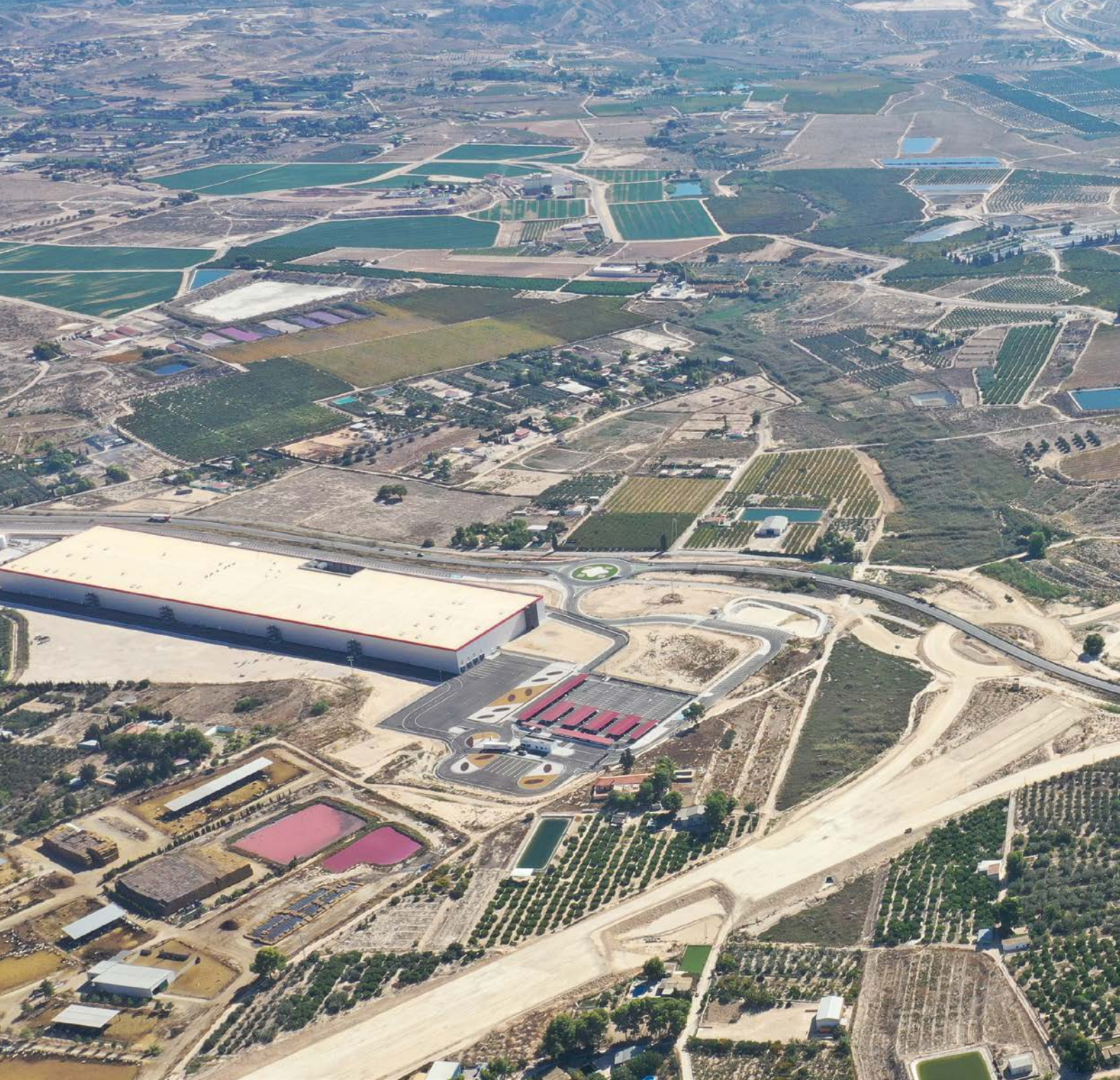
Vista aérea del trazado en obras con el enlace de Las Torres de Cotillas en primer plano.
