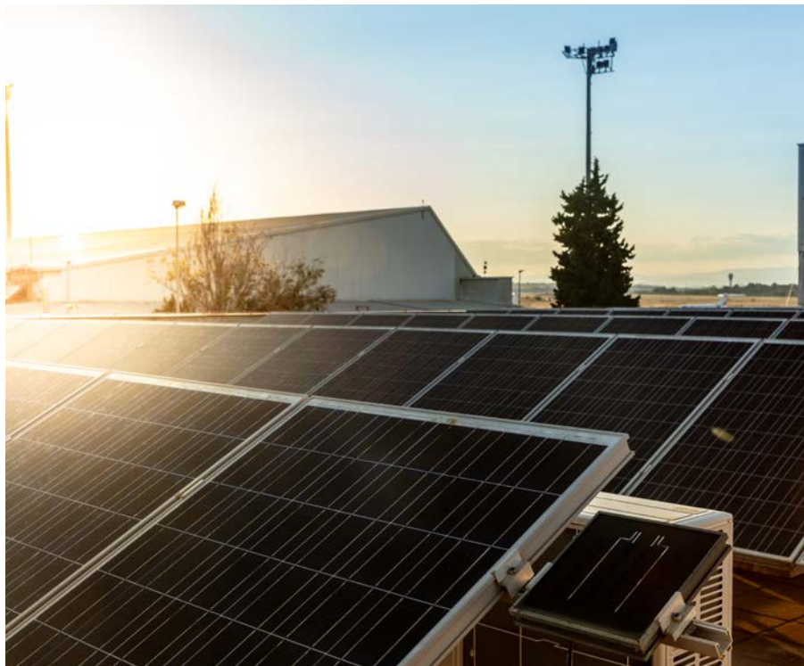
Paneles solares en Valencia.
