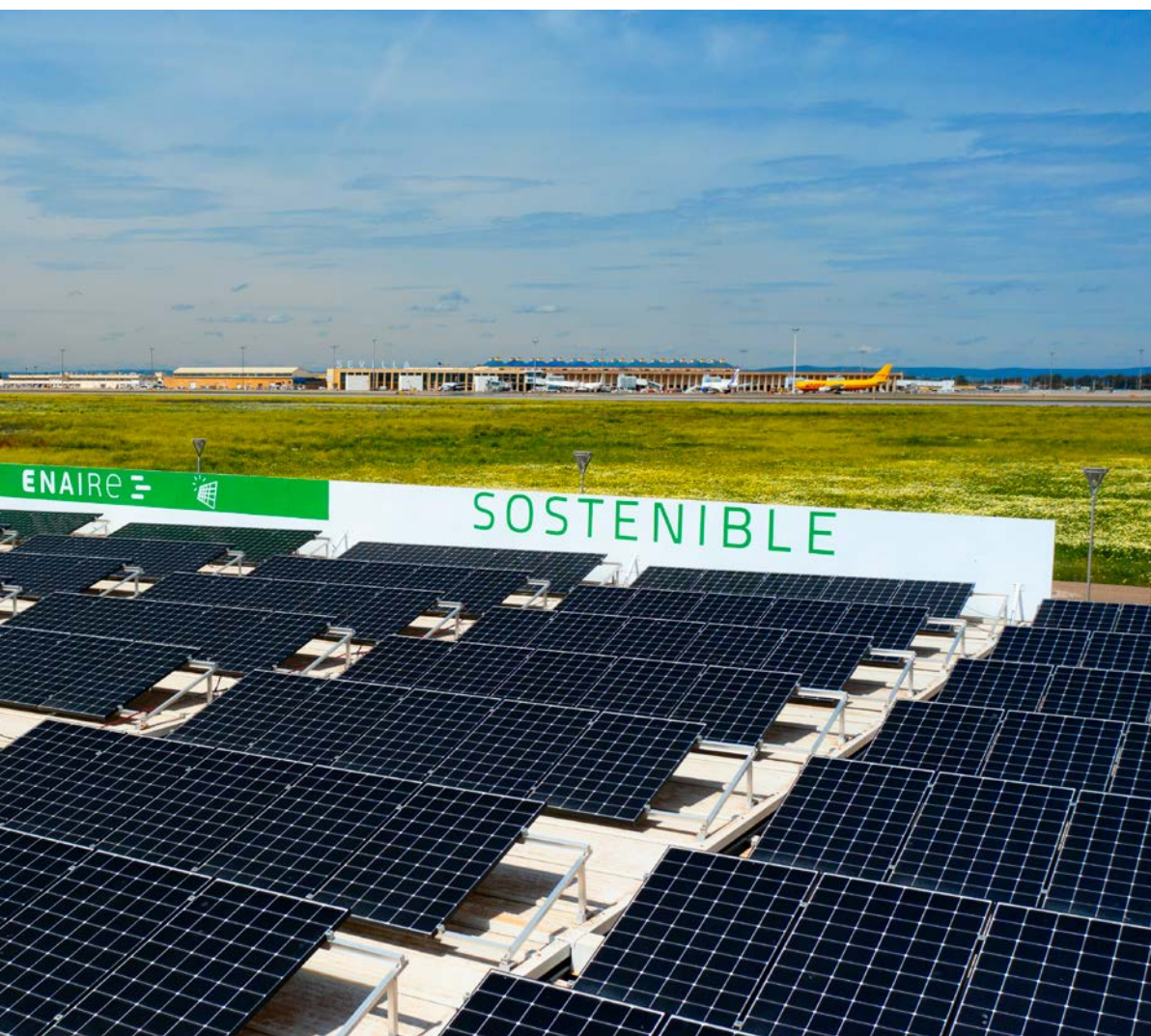
Paneles solares en Sevilla.
