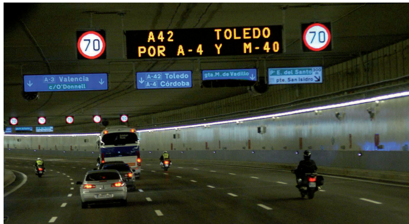
Paneles de información en el interior de un túnel.
