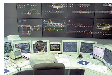
Centro de control Ferroviario.
