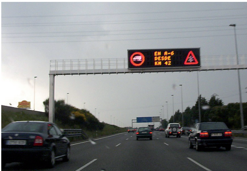
Sistema de información en carretera.
