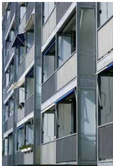
Detalle del cuerpo de terrazas adosado a la fachada original. © Ainhoa Díez.
