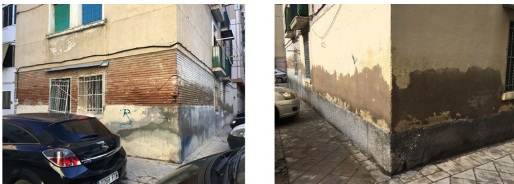
FIG. 1/ Humedades existentes en las plantas bajas de los edificios.
