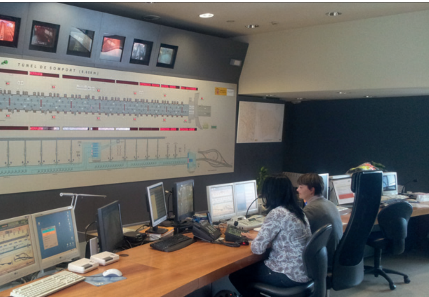
► El interior y los accesos del túnel son permanentemente monitorizados desde el centro de control y mando principal de la boca española.
