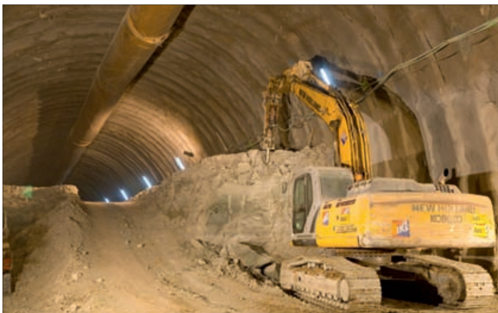
▶ Ejecución en la fase de destroza del túnel del Almendro, en el subtramo Nudo de Venta de Baños-Torquemada.
