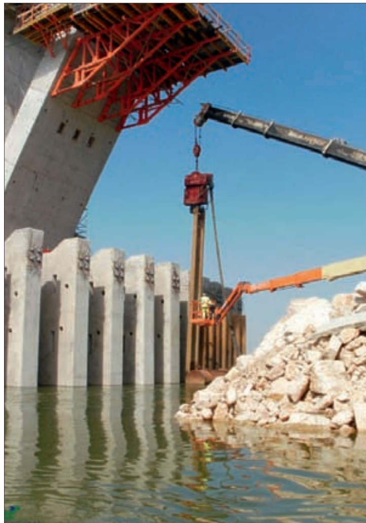
▸ Vista de la plataforma mixta (arriba) y trabajos de cimentación en el río (debajo).
