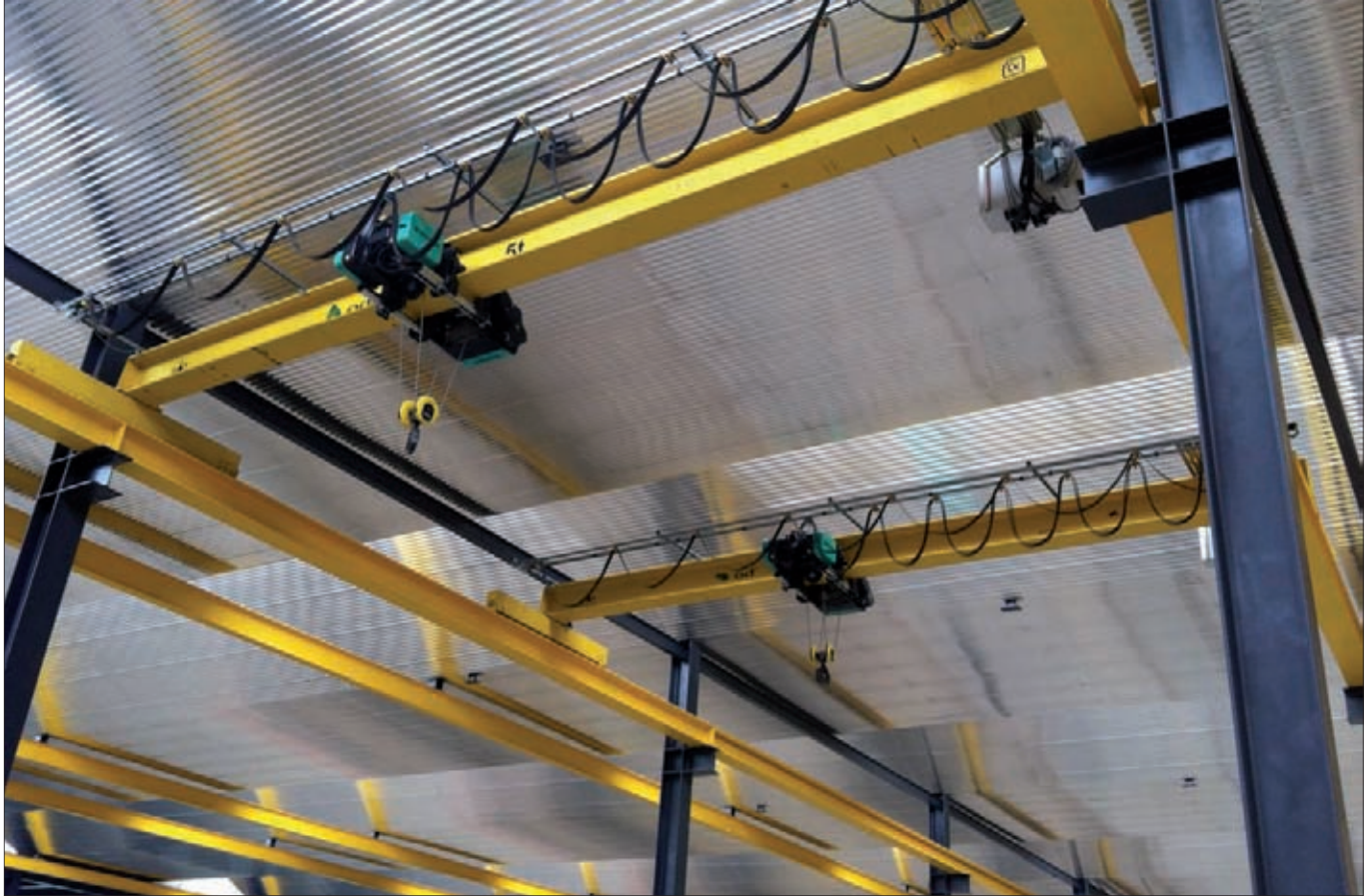
► El área de taller multifuncional incorpora puentes-grúa, un sistema de elevación de cargas de hasta 25 toneladas.
