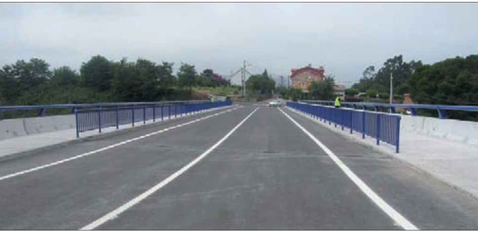
► Paso superior sobre la vía férrea (arriba) y paso superior San Blas-Matalobos (debajo).
