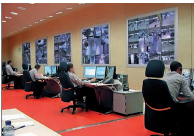
► Interior del CGA, cerebro del aeropuerto de Madrid-Barajas.
