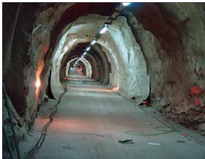
► Galería auxiliar de seguridad del túnel.
