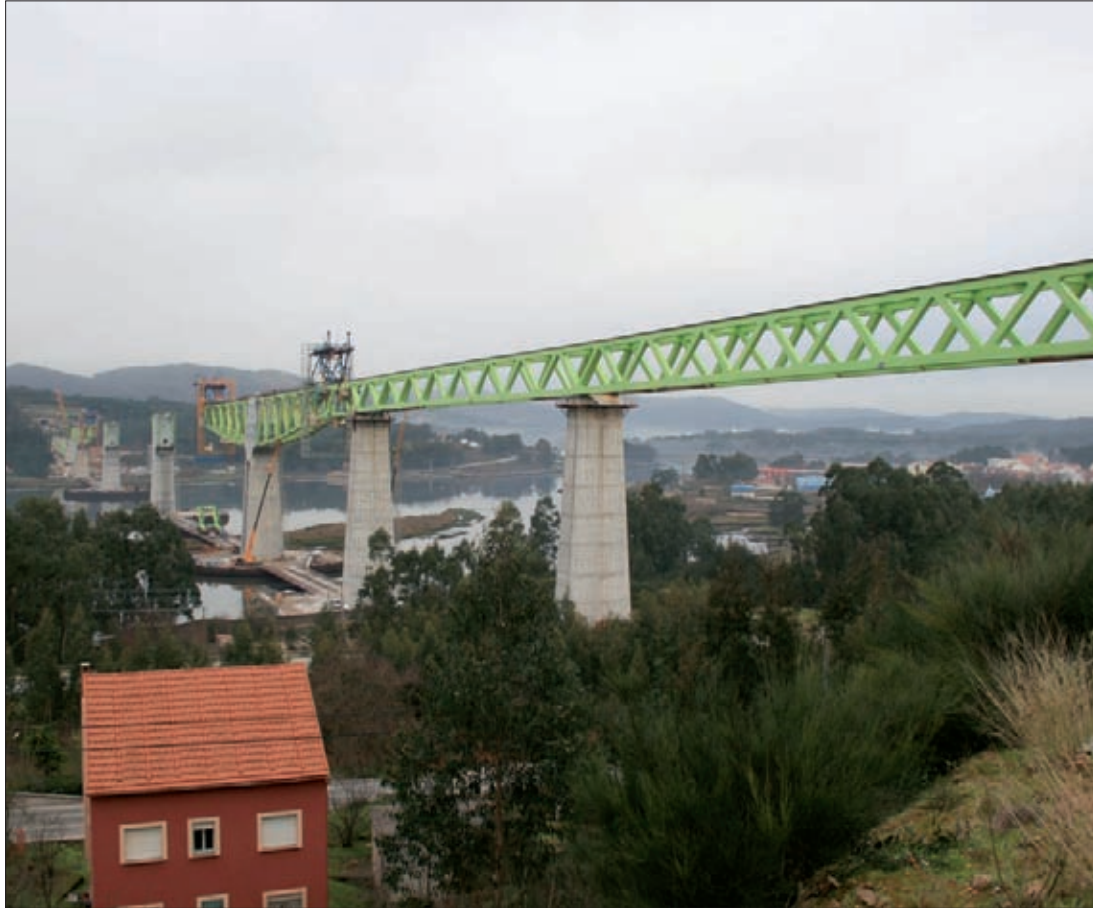
► Avance de la estructura metálica desde uno de los tramos de acceso del viaducto.
