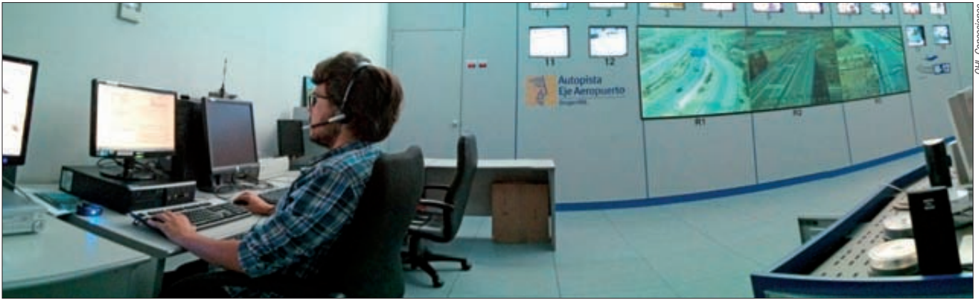
► El Centro de Control de Tráfico del Eje Aeropuerto (M-12) supervisó los ensayos sobre servicios FOTsis en esta autopista, entre ellos la gestión de emergencias.
