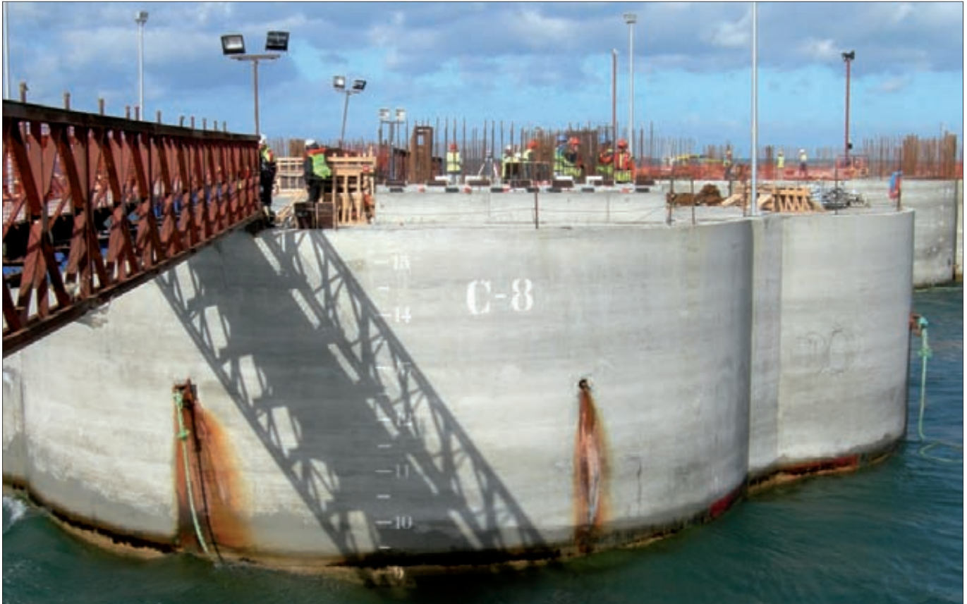
► Terminal GNL de Arzew (Argelia).
