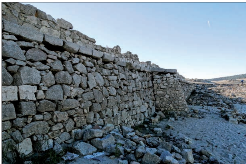
► Restos del puente sobre el arroyo del Tercio.
