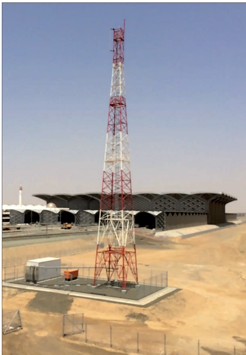
► Antena de comunicaciones frente a la estación KAEC.
