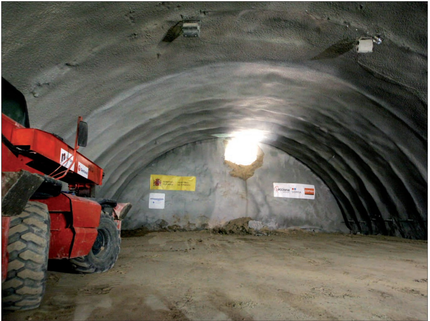
► Cale del tubo 1 del túnel de Olesa, la actuación más compleja del tramo.
