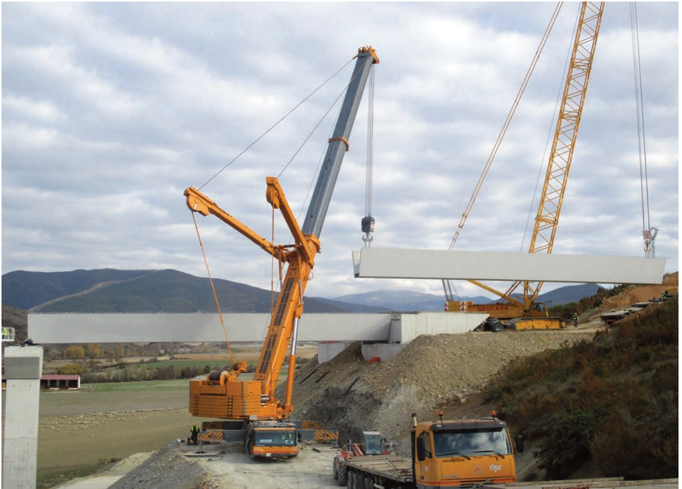
► Izado para el montaje de viga artesa en uno de los viaductos del tramo.
