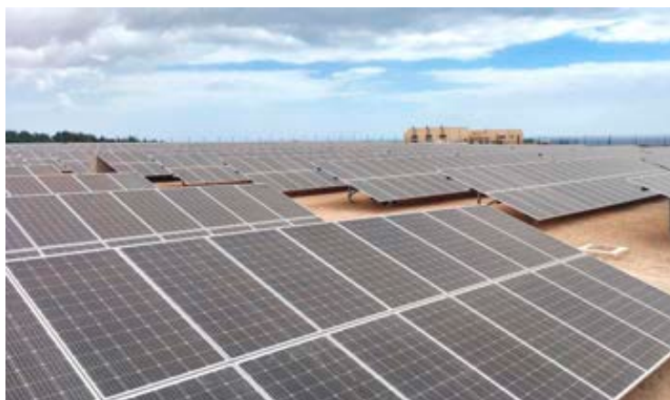
Planta solar fotovoltaica en el Aeropuerto de Fuerteventura
