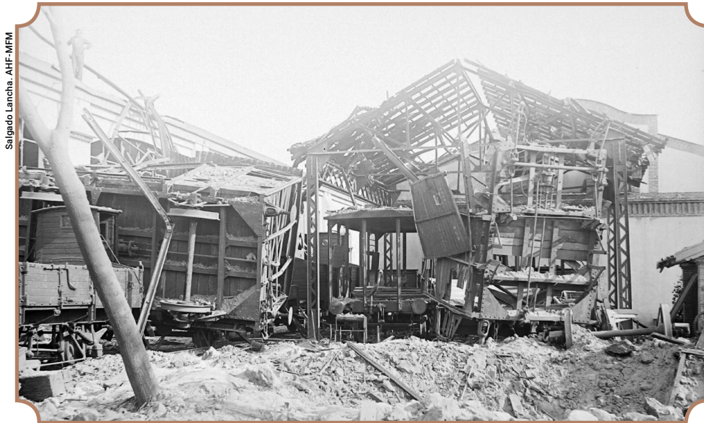
Destrozos en el Taller Central de Vía y Obras de Villaverde Bajo (ca. 1936).
