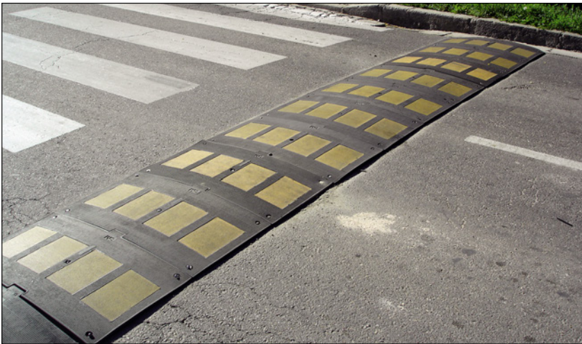
Banda reductora de velocidad.
